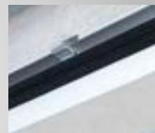
01 • A borracha na padieira melhora a estanquidade do portão e a estética do portão no lado exterior.
